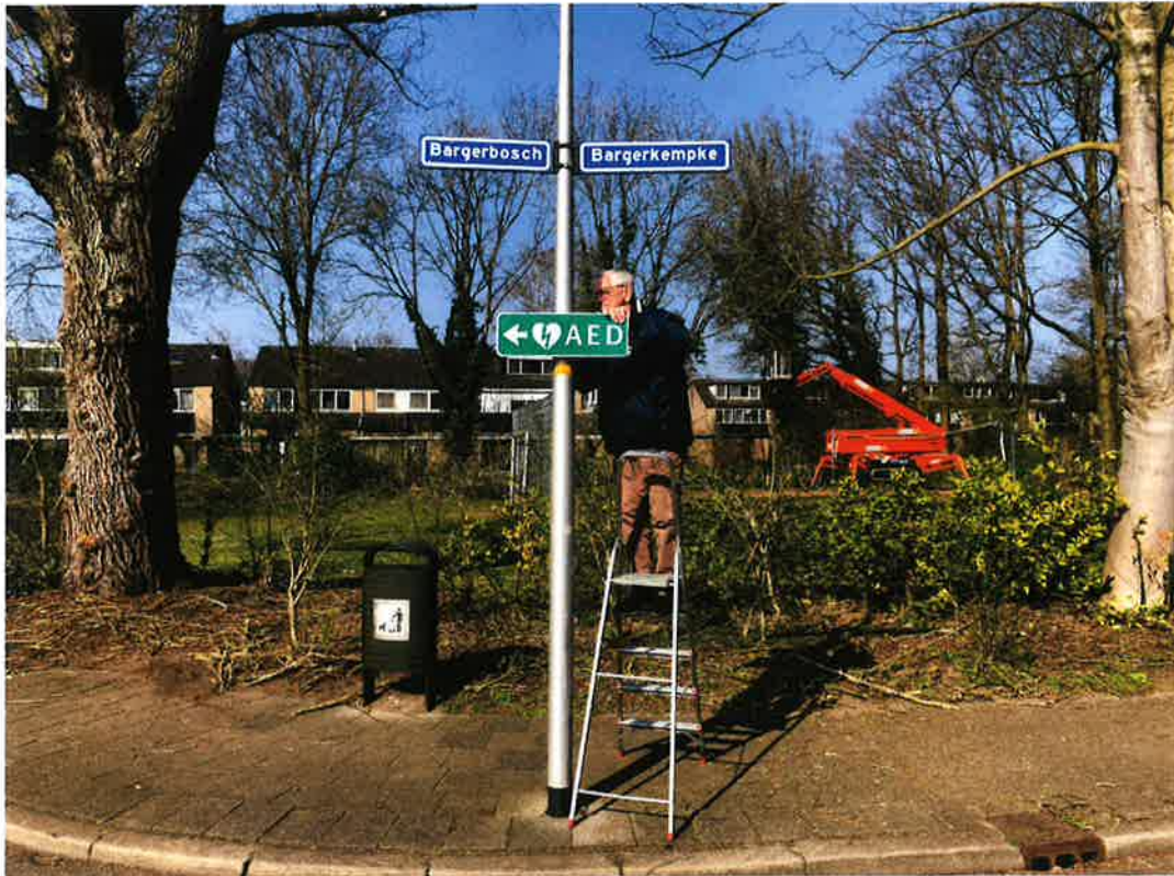
Montage AED-verwijsborden Bargerbosch
