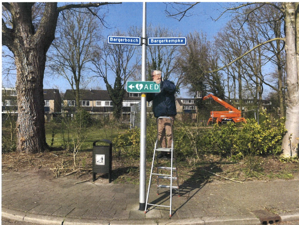
Montage AED-verwijsborden Bargerbosch
